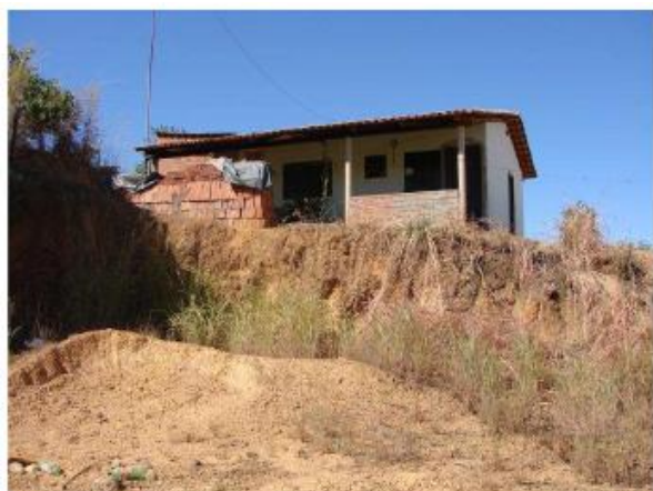
Foto 3: Ocupações em área de risco de destabilização
