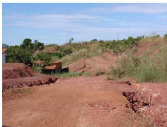
Foto 2: Processo Erosivo - Via
