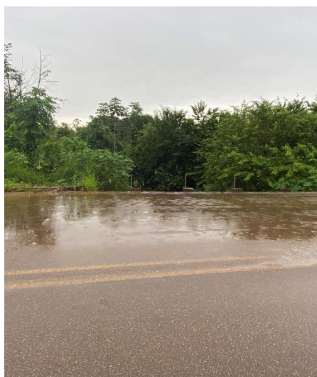
Vista sobre tubulação de passagem.
