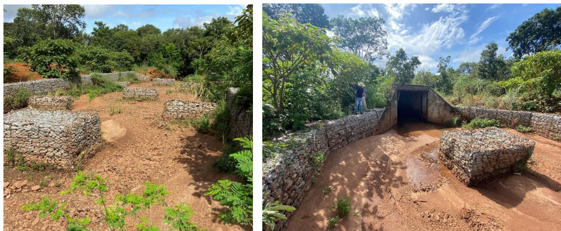
Blocos de dissipação de energia apresentam deformações e perda de volume (brita escapando pela malha).
