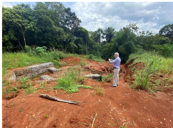
Acesso irrestrito ao dispositivo de drenagem
