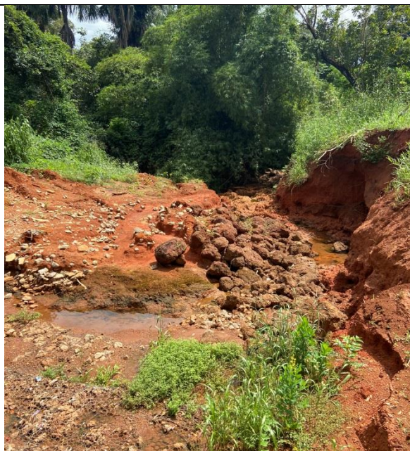
Ravinamento, imediatamente à jusante do dispositivo.
