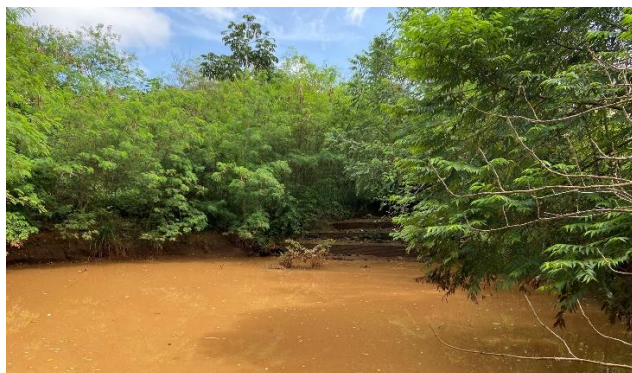
Observa-se o desemboque da galeria de drenagem, com formação de represamento à jusante.
