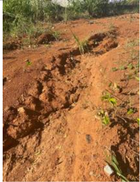
Erosão devido à enxurradas, por escoamento superficial
