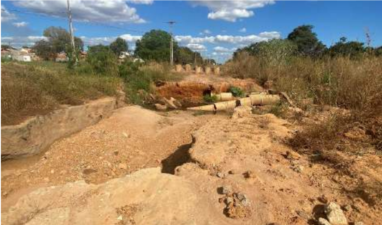
Erosão na via pública com tubulação colapsada
