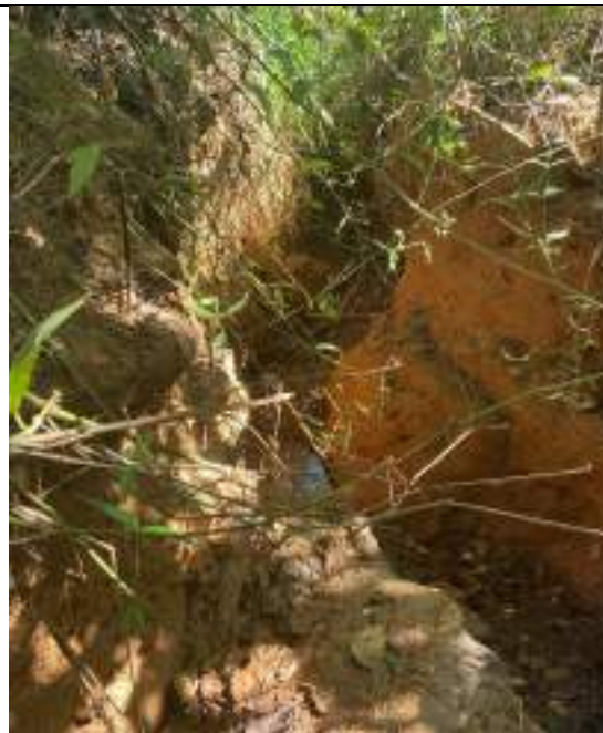
Processo de forte erosão e ravinamento
