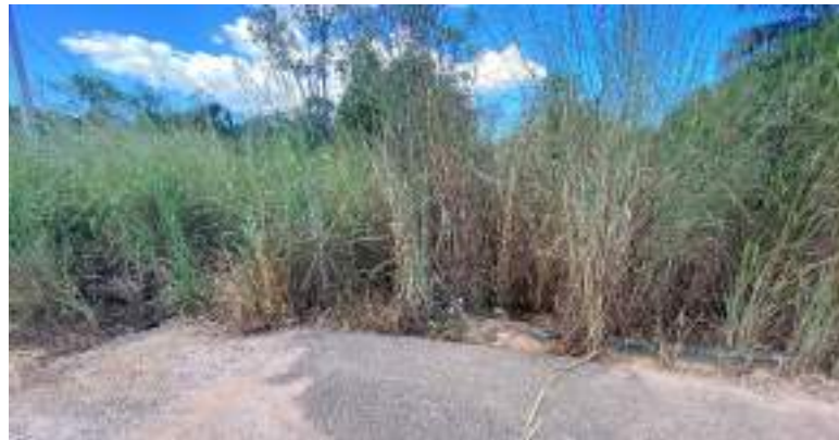
Aparente ponto mais baixo de escoamento – e alagamento - acúmulo de sedimentos
