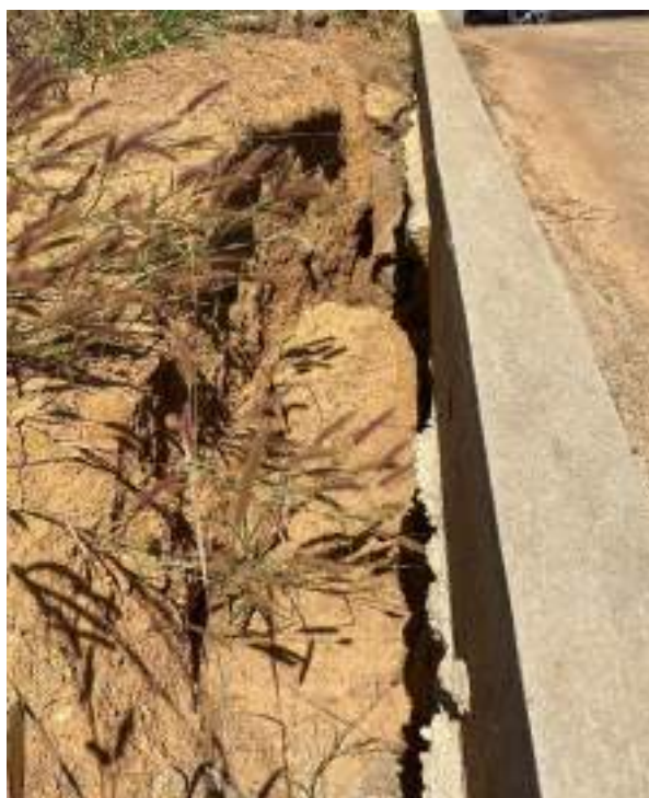
Problemas de erosão do solo adjacente à estrutura do extravasor superficial
