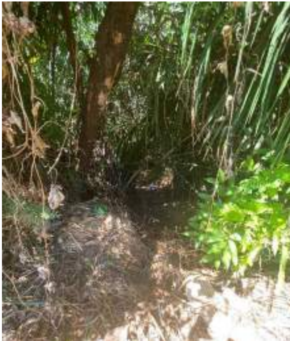
Encaminhamento da rede, ponto de descarga inacessível
