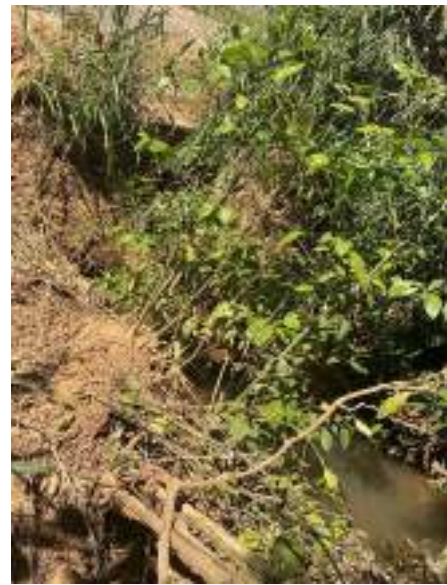
Desemboque da rede obstruído
