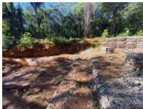
Leve assoreamento, à jusante da estrutura
