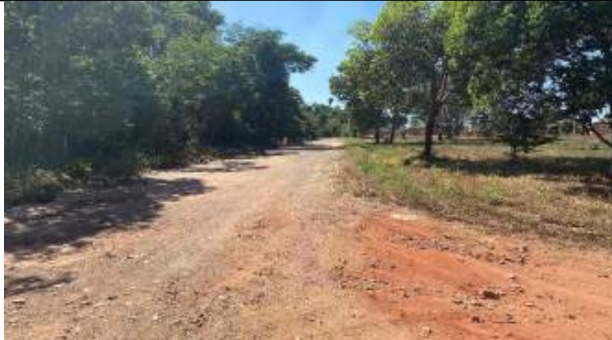
Via marginal do perímetro da APP nº01 – sem pavimentação adequada nem calçamento ou cercas de proteção
