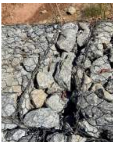
Problemas nos gabiões – malha danificada
