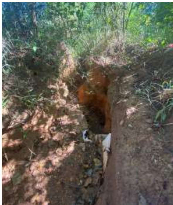
Calha do canal à céu aberto erodida
