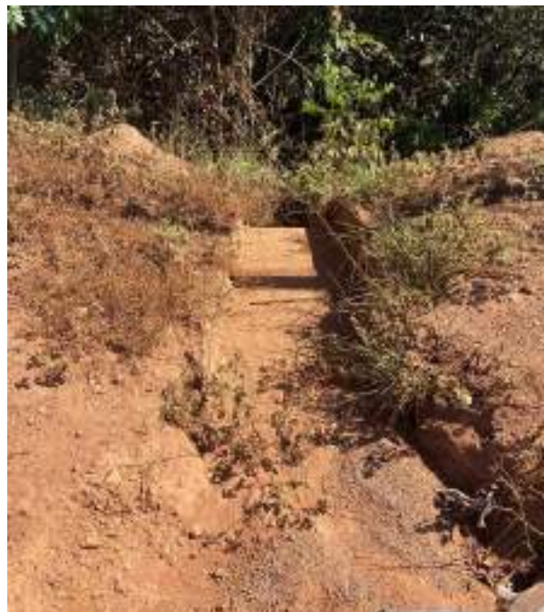
Emboque do escoamento superficial sem manutenção
