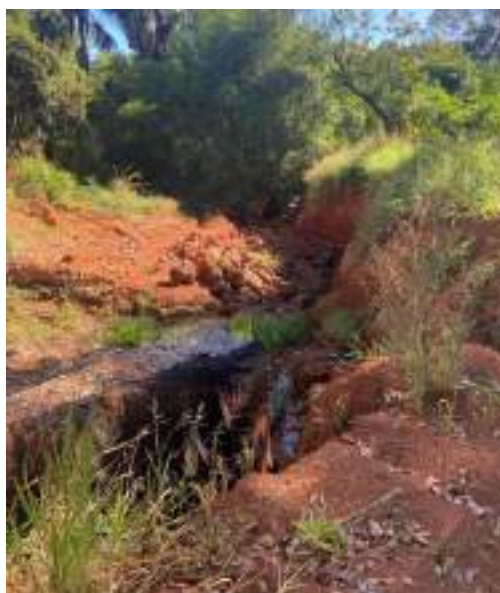
Erosão e Ravinamento em torno da estrutura
