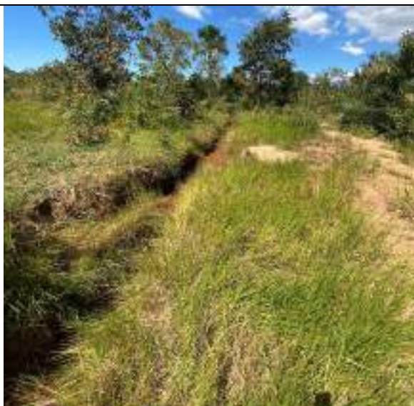
Vista do canal à céu aberto, desague incerto
