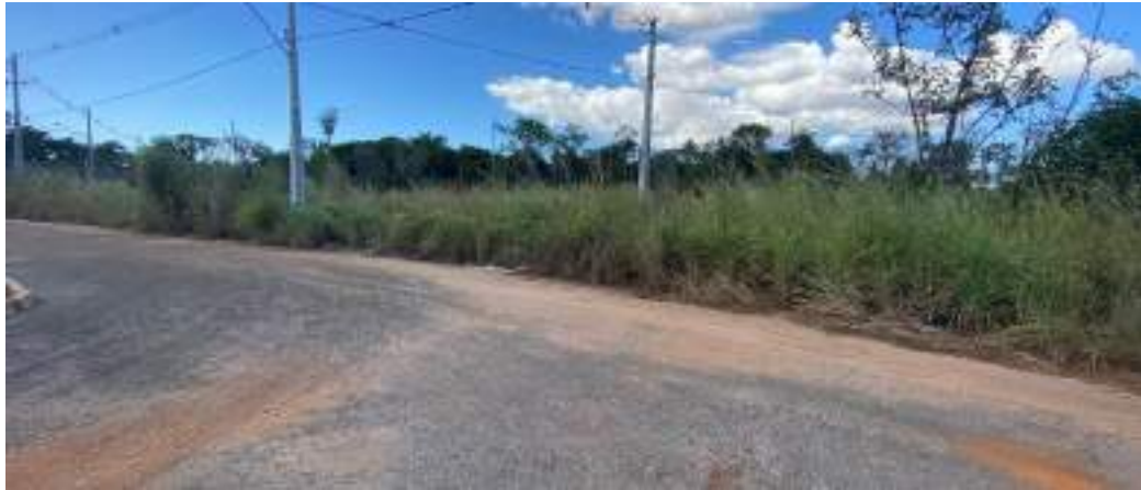
Vista da Rua, sem calçamento nem drenagem superficial visível. Nenhum tipo de sinalização
