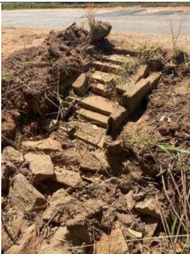
Detalhe da escada hidráulica colapsada
