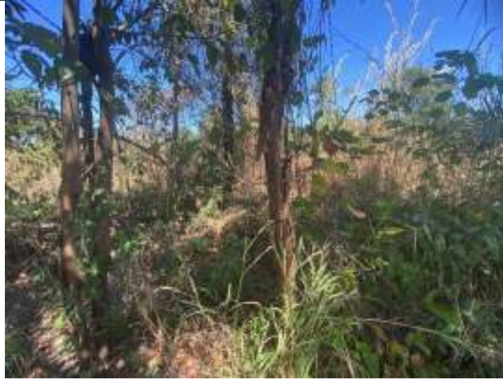
Infestação vegetal inviabiliza o acesso à rede de drenagem
