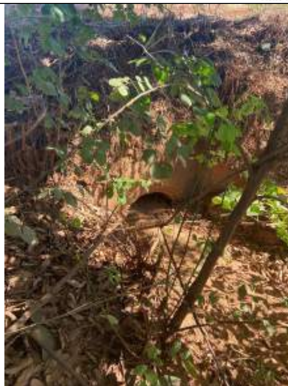
Tubo de passagem (600mm) obstruído
