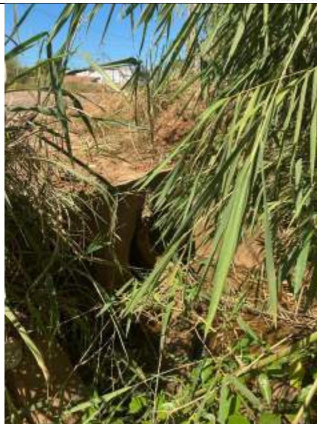
Vista do desemboque de rede obstruído
