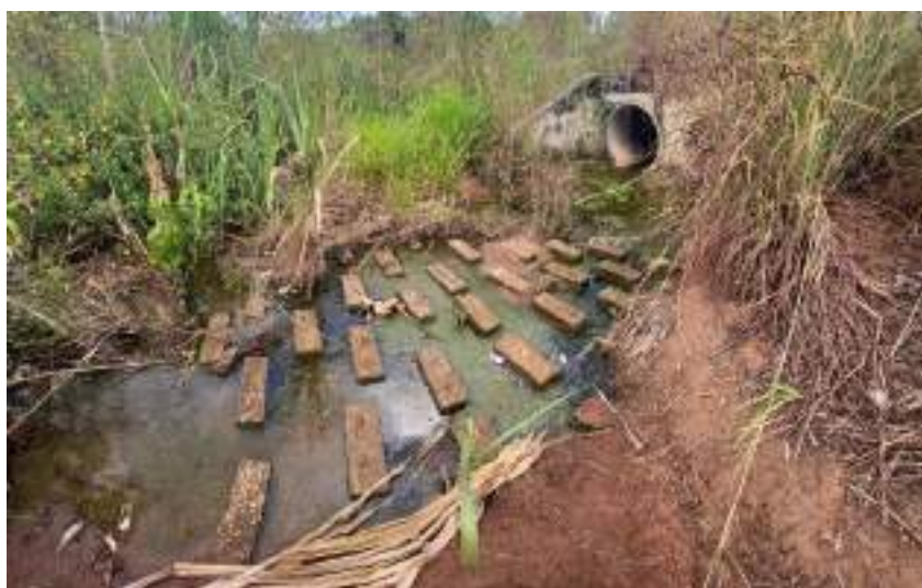
Vista do Ponto de Lançamento – escoamento prejudicado – formação de limbo denota água parada
