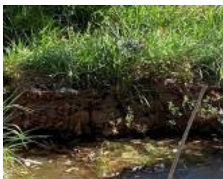
Gabião infestado por vegetação – resultado da falta de limpeza e manutenção
