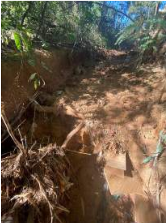
Vista à montante – entulho, lixo e erosão
