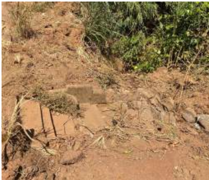
Dispositivo de escoamento superficial colapsado
