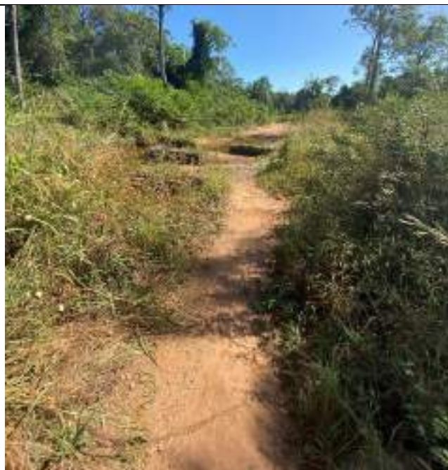
Pequena trilha de tráfego, passando pela estrutura de descarga da rede de drenagem
