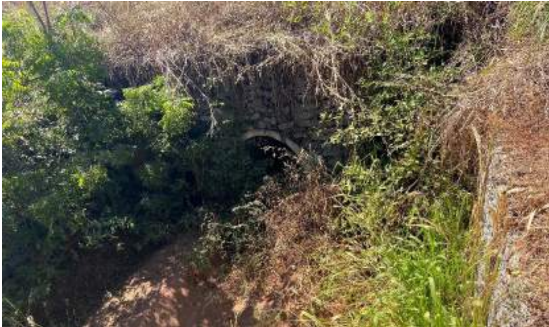
Desemboque da rede de drenagem (3 tubos de 600mm), parcialmente obstruído
