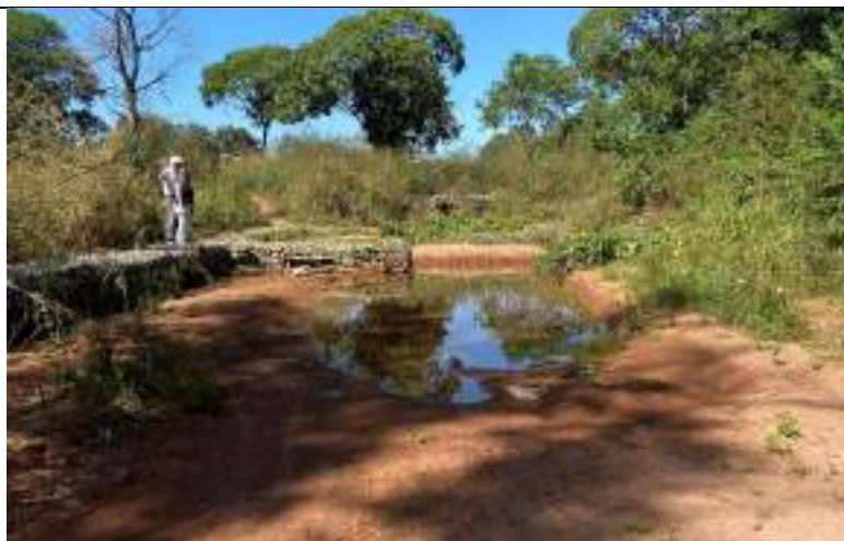
Retenção de água devido à significativo acúmulo de “areia fina” ao longo da estrutura
