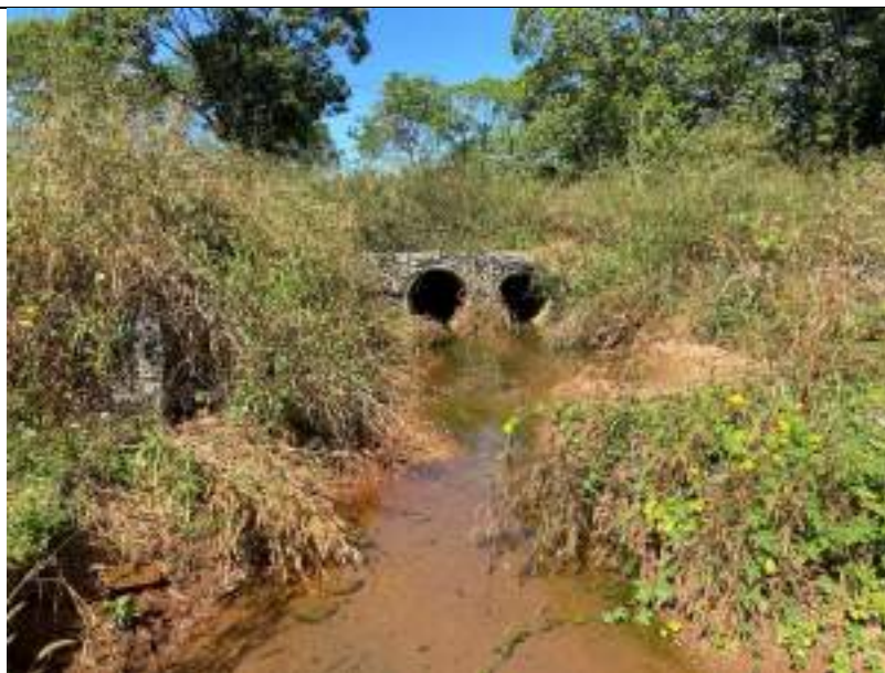
Descarga em 2 tubos de 600mm - assoreamento e infestação vegetal – necessário limpeza e manutenção
