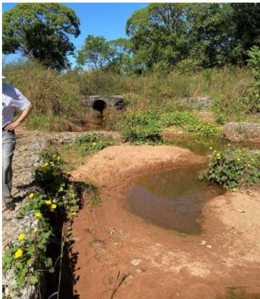
Intenso acúmulo sedimentar devido à assoreamento na estrutura - efeito é esperado, mas requer dragagem e limpeza
