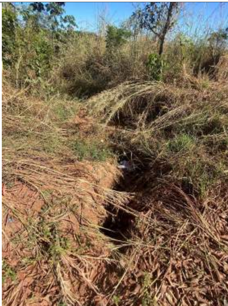
Jusante da tubulação de passagem obstruída: apenas vertimento de águas superficiais e muitos detritos
