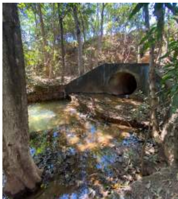
Desemboque da rede de drenagem
