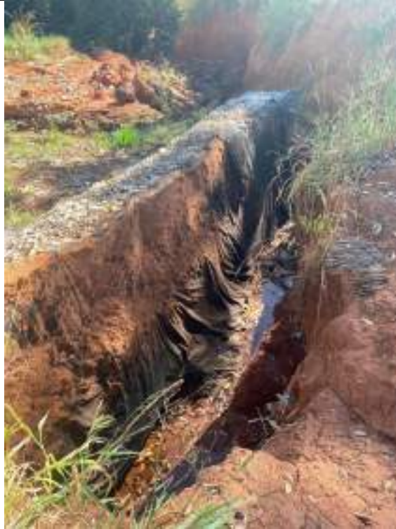
Processo de forte erosão adjacente à ala do dispositivo
