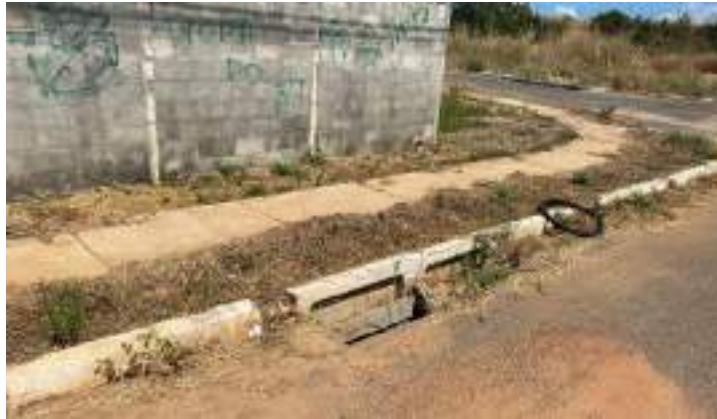
Bocas de lobo danificadas e parcialmente obstruídas
