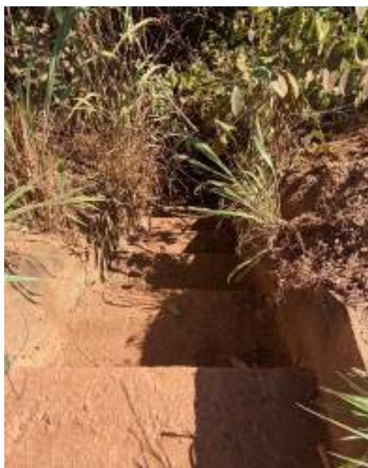
Descarga superficial em escada, para dissipação de energia
