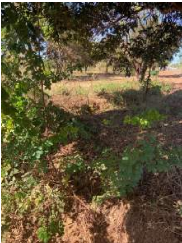
Processo erosivo de formação de vala de escoamento
