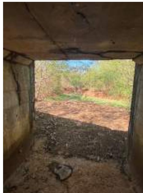
Pequena bacia de retenção no desemboque da rede
