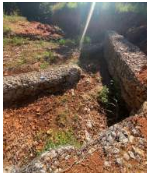
Estrutura íntegra, mas requer manutenção
