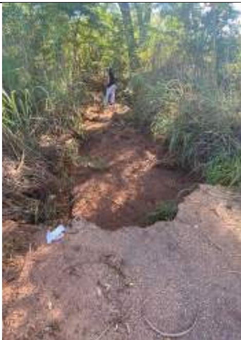
Pavimento e Calçamento colapsados
