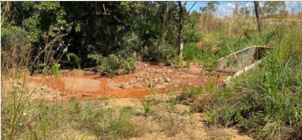
Vista geral do lançamento de rede – aparente tendência à carreamento de sólidos, dissipação de energia ineficaz
