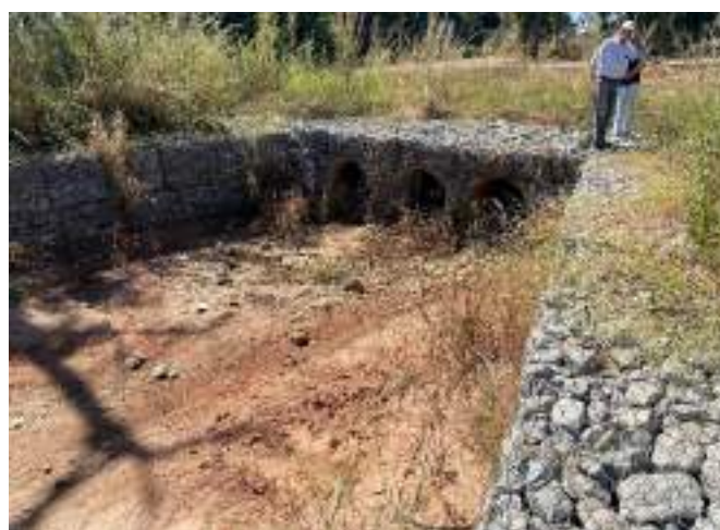
Descarga da rede de drenagem em 3 tubos de 600mm
