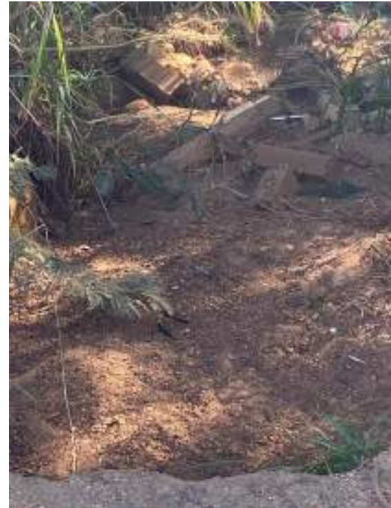
Vista à jusante – colapso do pavimento/calçamento – nota-se o carregamento dos blocos das guias
