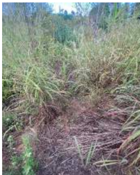
Infestação da vegetal impede acesso adequado à rede de drenagem
