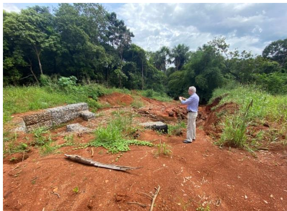
Acesso irrestrito ao dispositivo de drenagem
