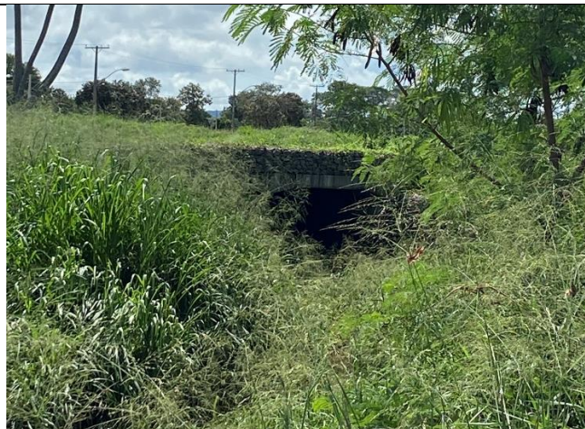
Acesso ao desemboque da galeria obstruído por vegetação
