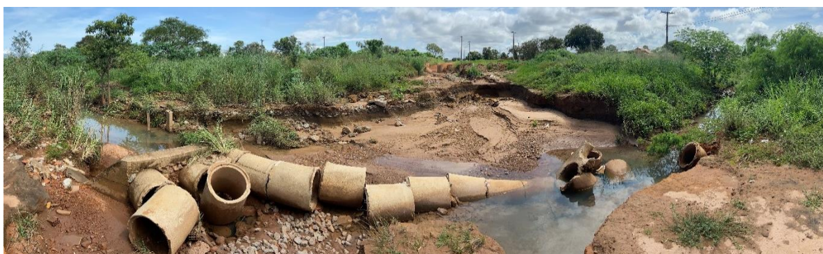
Vista Geral da estrutura colapsada (canal à céu aberto à montante e à jusante)
