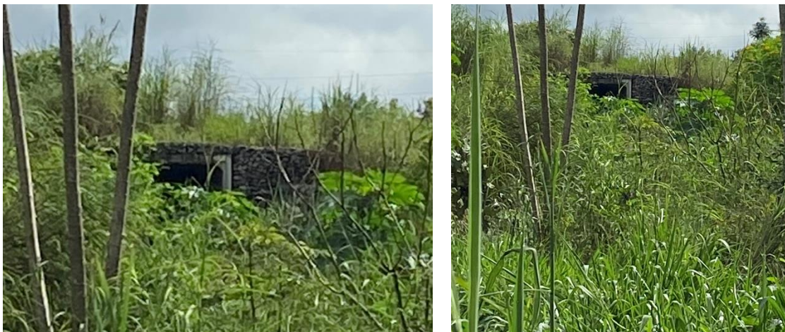
Desemboque de galeria de drenagem sem acesso para manutenção preventiva.
