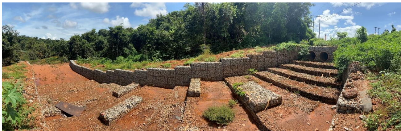
Vista Panorâmica do Ponto de Lançamento – observa-se deposição de sedimentos, entulho, perda de material dos gabiões e vegetação a ser removida, para evitar obstruções.
