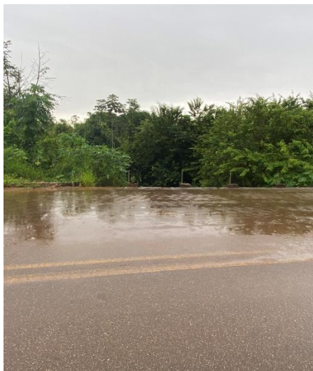
Vista sobre tubulação de passagem.
