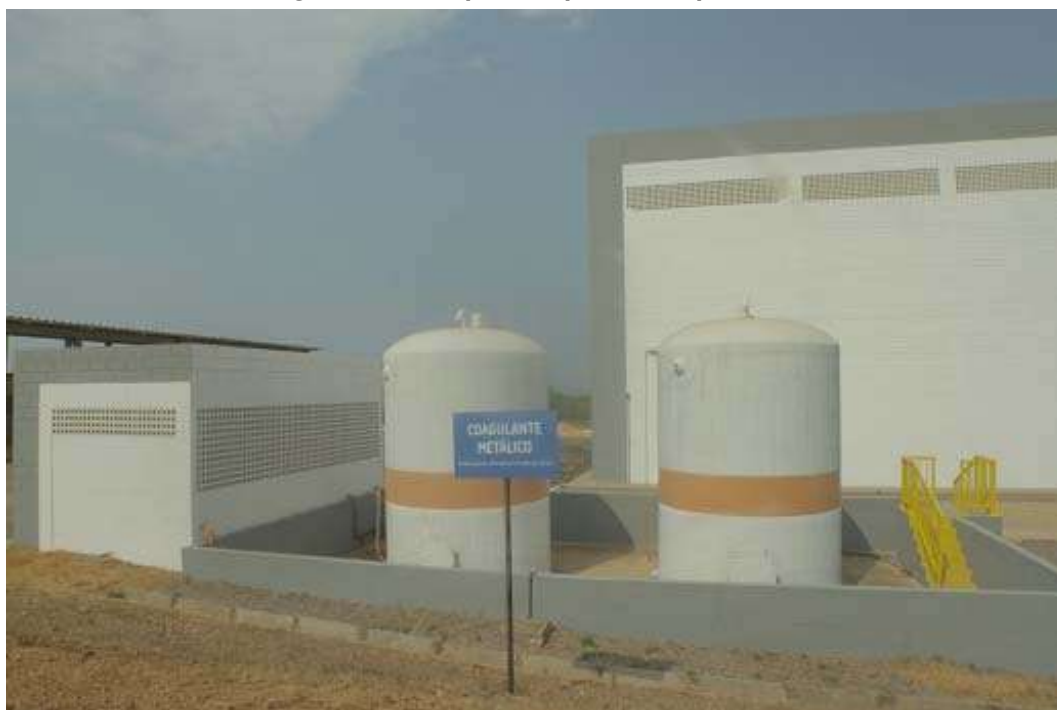
Figura 98. Tanques de produtos químicos
