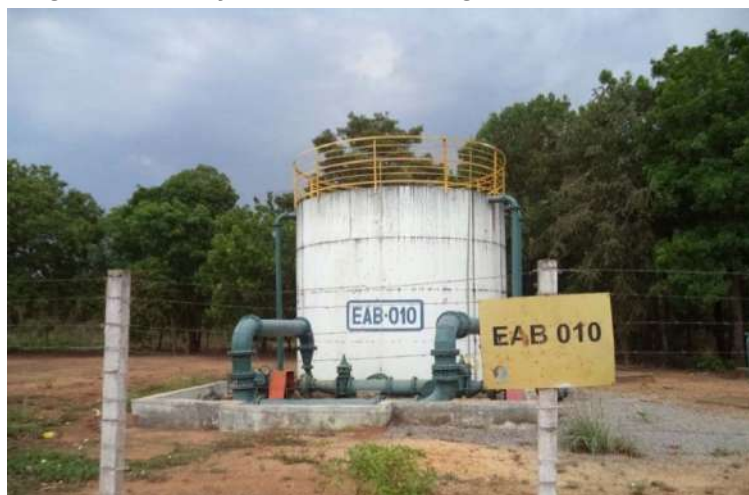
Figura 47. Estação Elevatória de Água Bruta – EEAB 010
