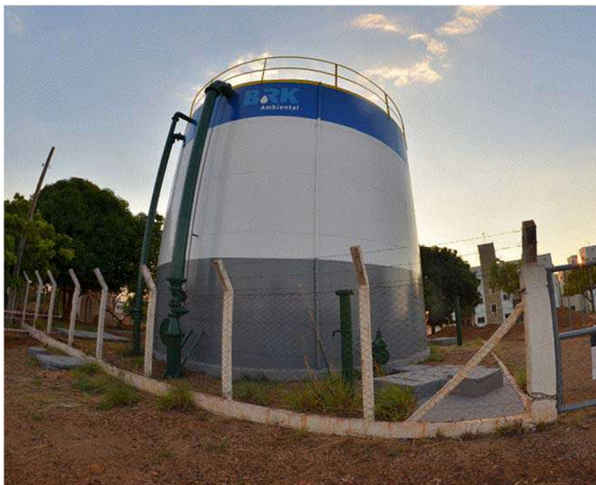
Figura 44. Reservatório Apoiado - RAP 006
