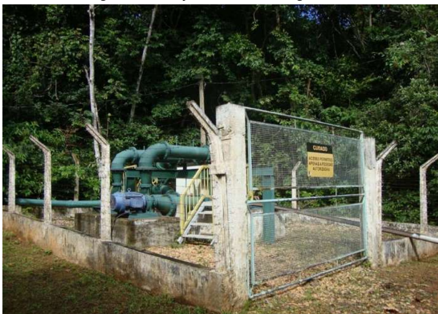
Figura 35. Estação elevatória de água bruta
