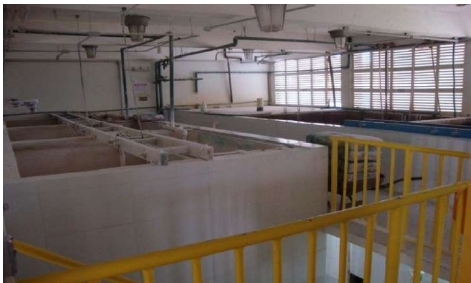
Figura 26. Depósito de produtos químicos
