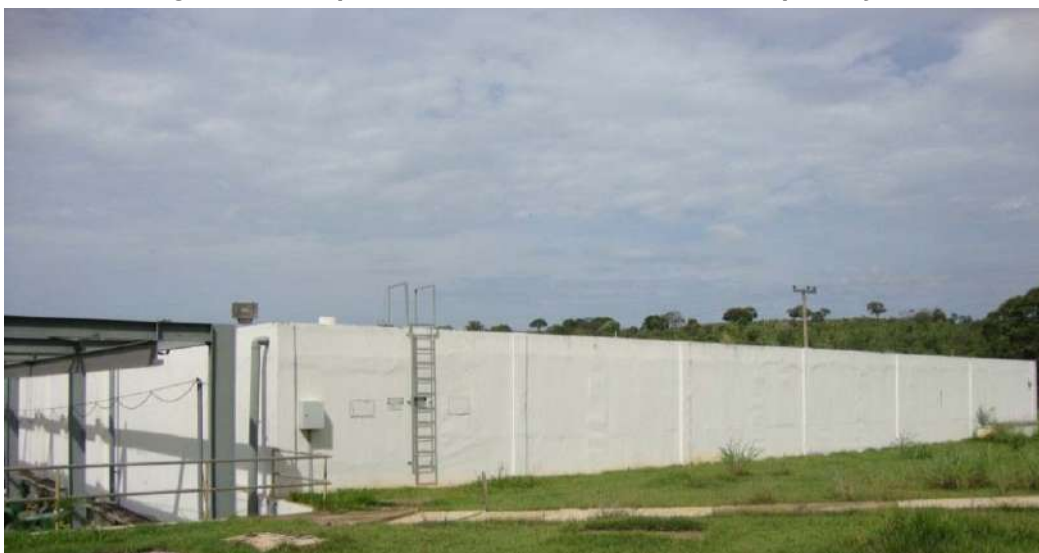
Figura 28. Tanque de contato/Reservatório de compensação
