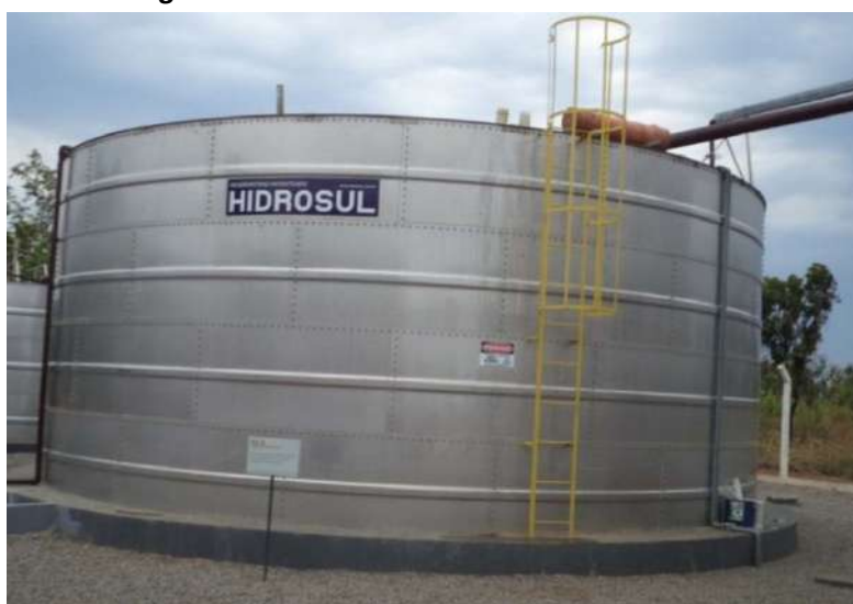
Figura 111. Reator de lodos ativados - RLA
