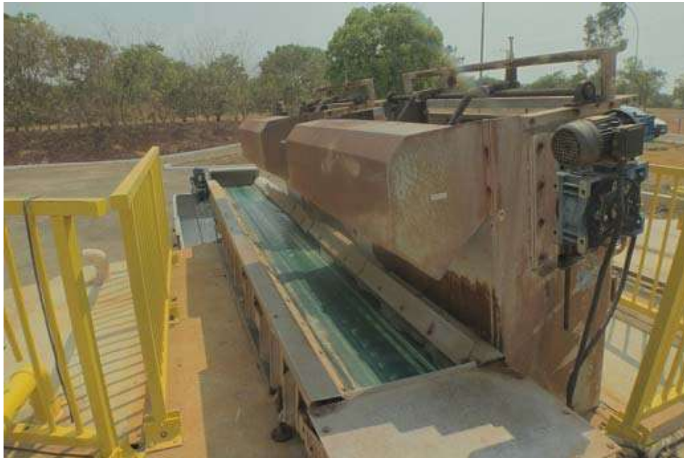
Figura 89. Gradeamento com esteira mecanizada com motor
