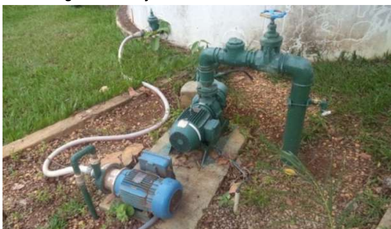
Figura 61. Conjunto motor bomba – EEAT 002
