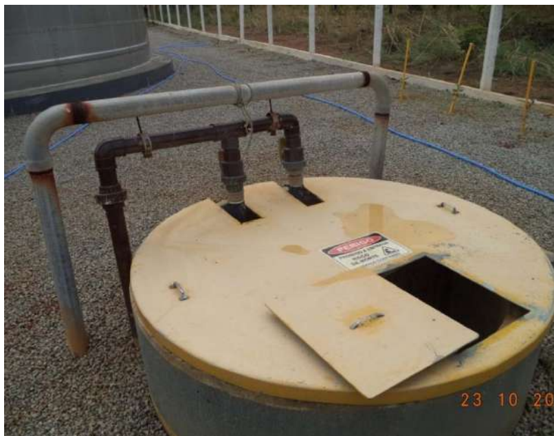
Figura 107. Poço de sucção - EEE Final
