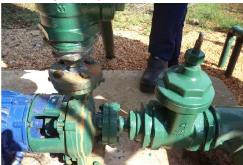
Figura 54. Conjunto motor bomba REL 001
