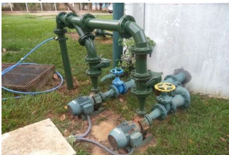
Figura 60 - Conjunto Motor-Bomba EEAT 001
