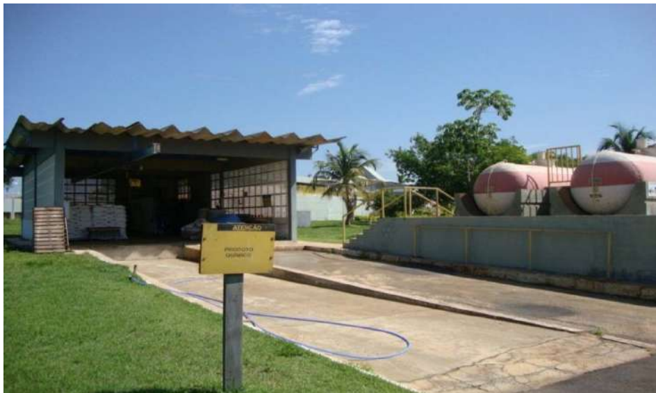
Figura 27. Abrigo e tanques armazenagem do cloro
