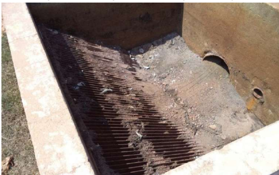
Figura 67. Caixa de gradeamento bruto para decantação
