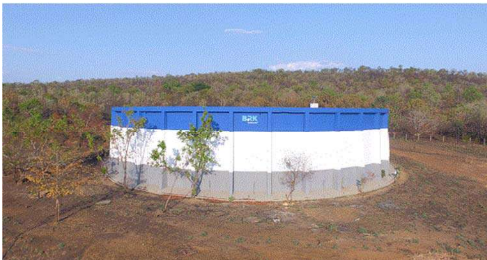
Figura 43. Reservatório Apoiado - RAP 002
