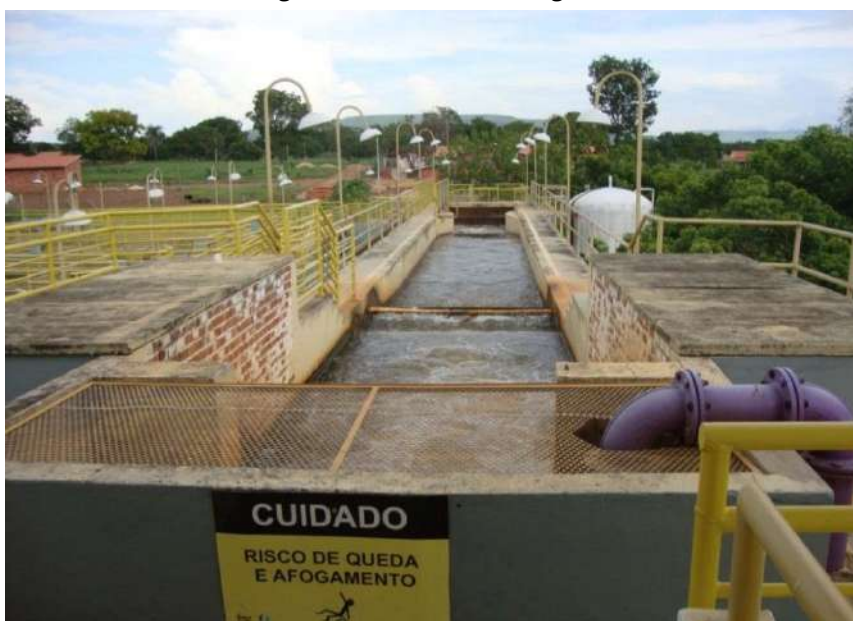
Figura 21. Caixa de chegada
