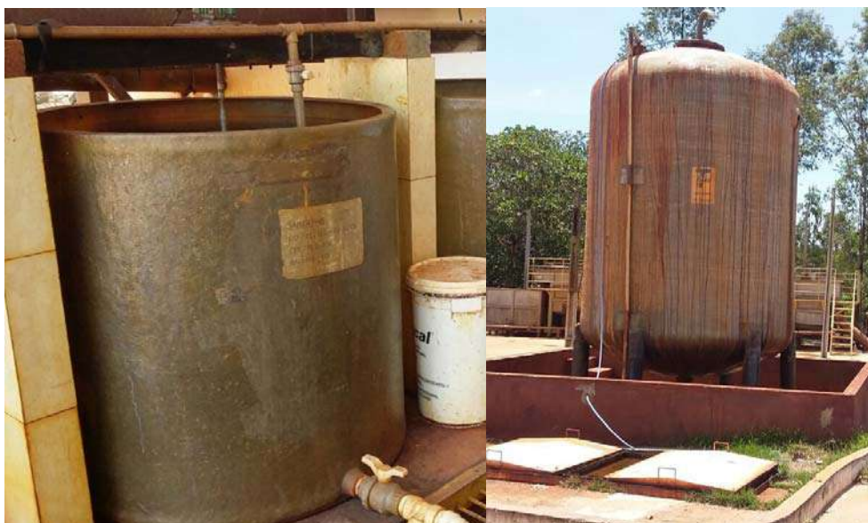
Figura 84. Tanques de produtos químicos
