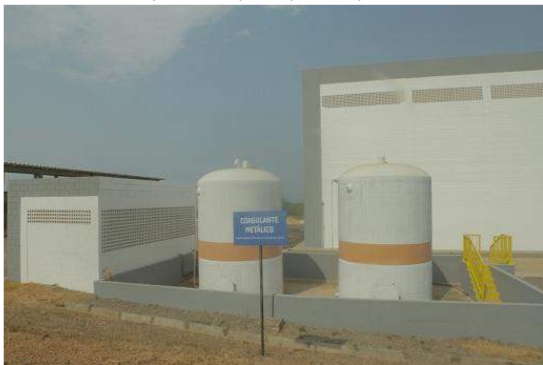
Figura 98. Tanques de produtos químicos
