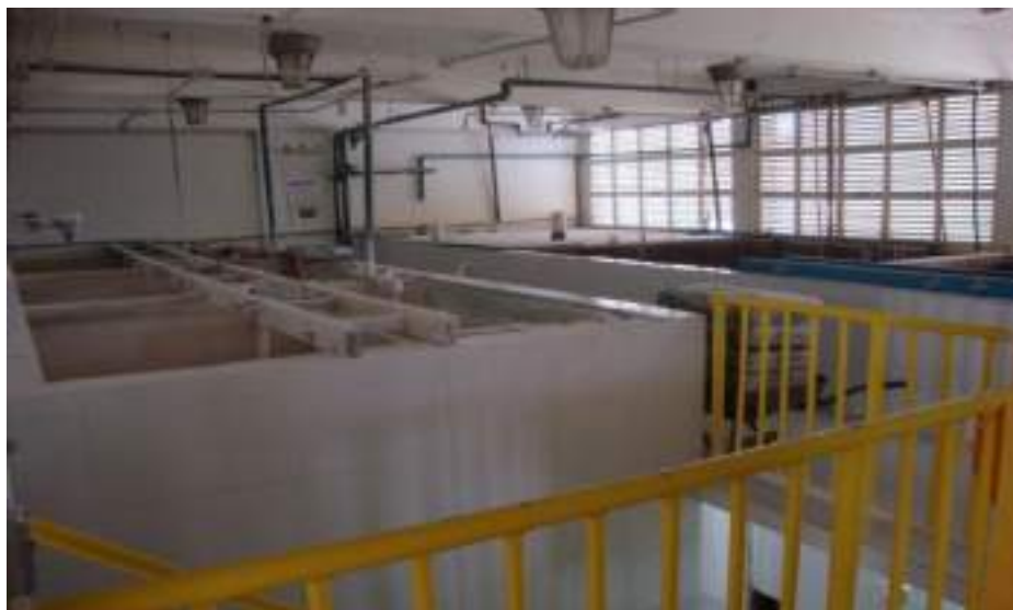
Figura 26. Depósito de produtos químicos
