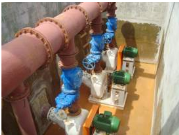
Figura 101. EEE Capim Dourado – EEE 008
