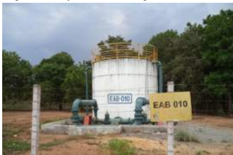
Figura 47. Estação Elevatória de Água Bruta – EEAB 010
