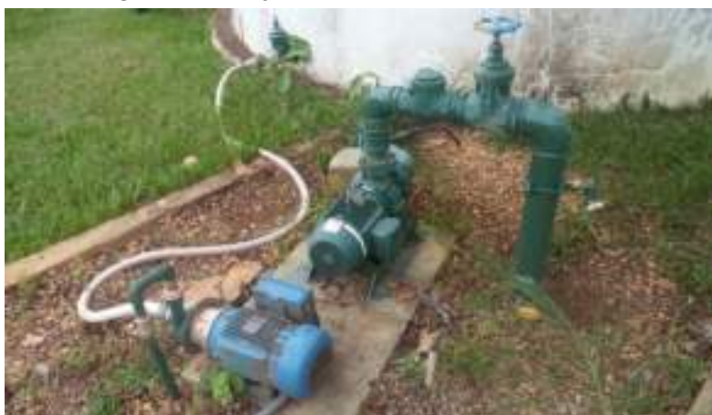
Figura 61. Conjunto motor bomba – EEAT 002
