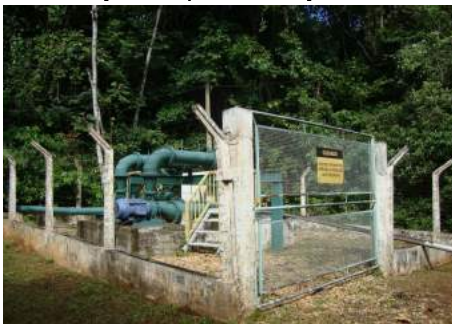
Figura 35. Estação elevatória de água bruta
