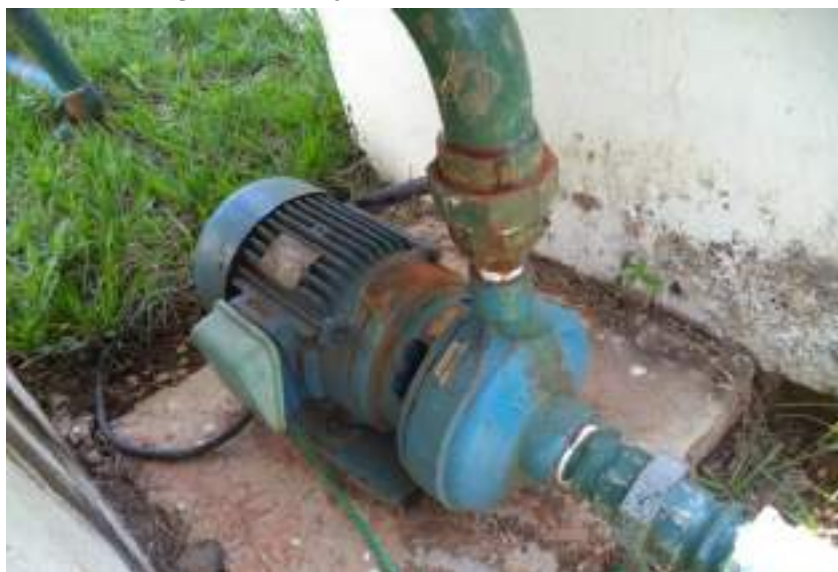
Figura 53. Conjunto motor-bomba RAP 001
