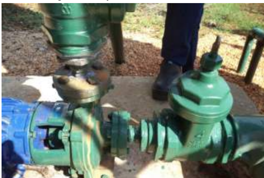
Figura 54. Conjunto motor bomba REL 001
