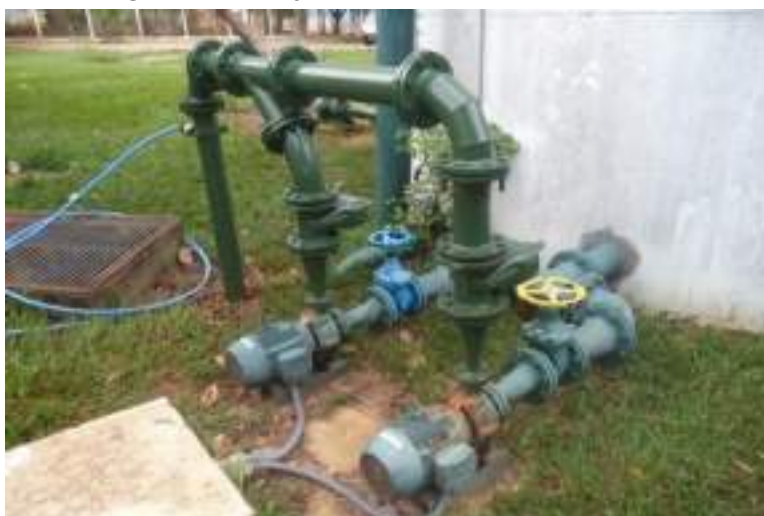
Figura 60 - Conjunto Motor-Bomba EEAT 001
