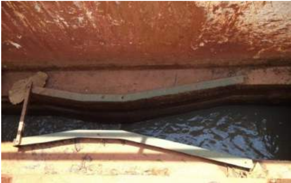
Figura 69. Calha Parshall de entrada
