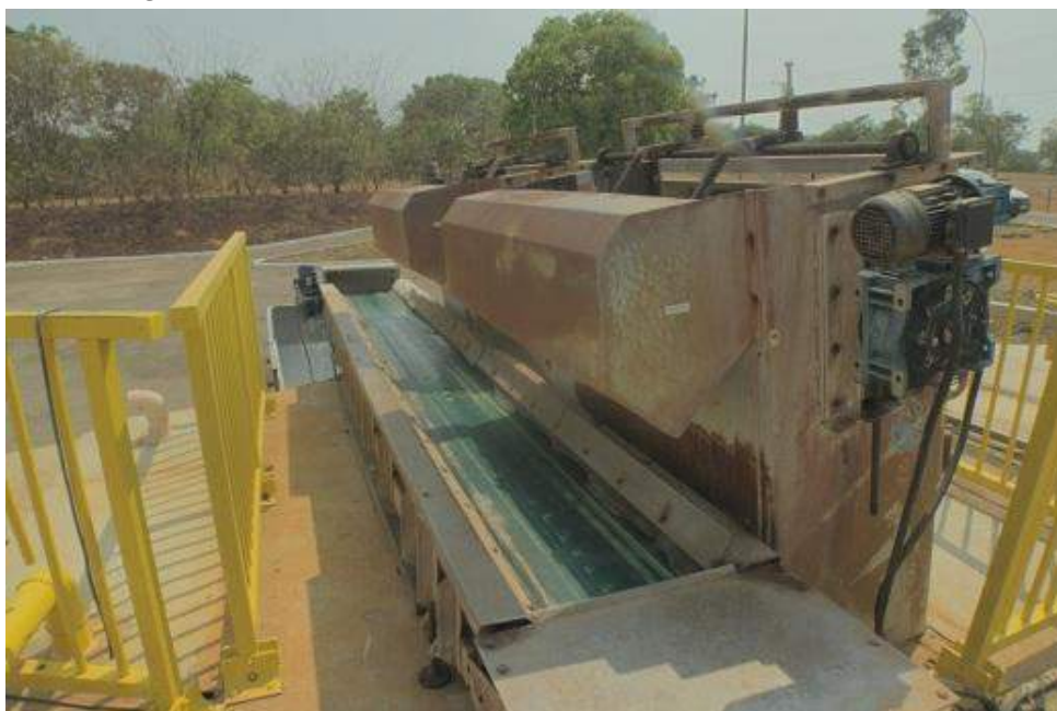
Figura 89. Gradeamento com esteira mecanizada com motor
