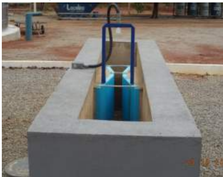
Figura 115. Calha Parshall de saída 6"
