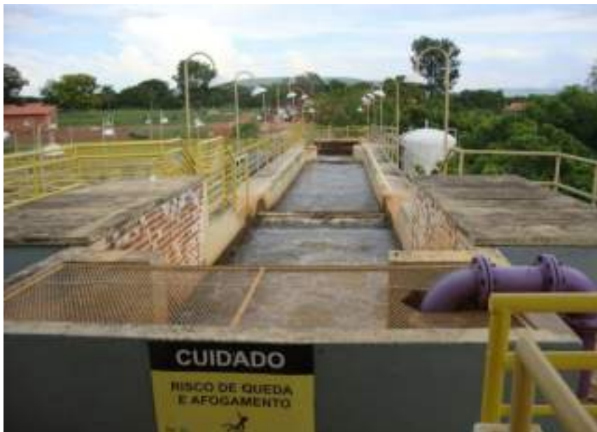
Figura 21. Caixa de chegada
