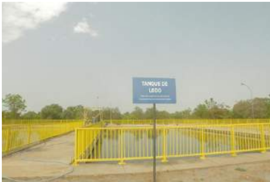
Figura 95. Tanque de lodo
