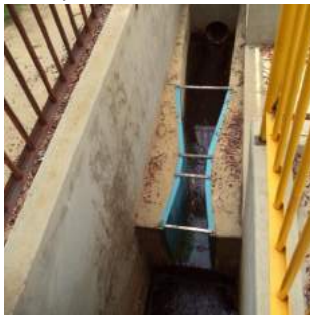
Figura 74. Calha Parshall de Saída
