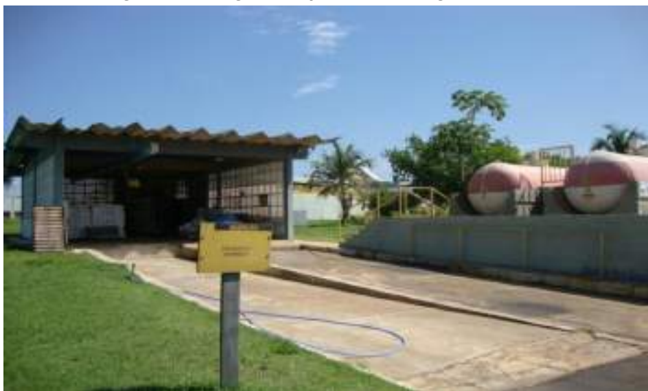
Figura 27. Abrigo e tanques armazenagem do cloro
