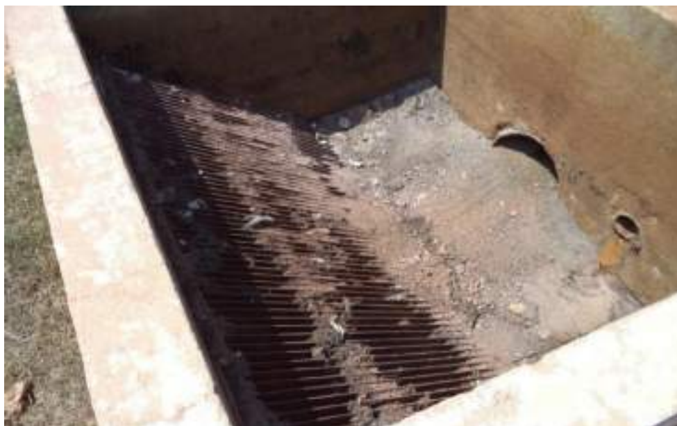
Figura 67. Caixa de gradeamento bruto para decantação
