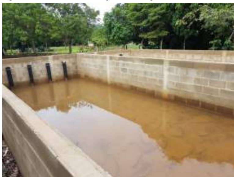
Figura 39. Tratamento da água de lavagem dos filtros
