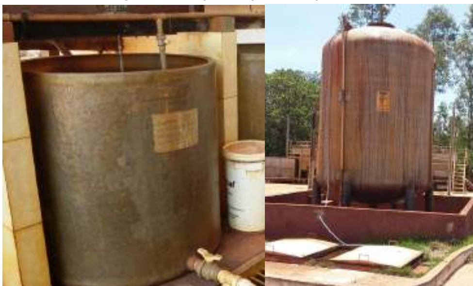
Figura 84. Tanques de produtos químicos
