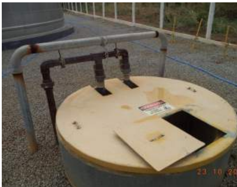
Figura 107. Poço de sucção - EEE Final
