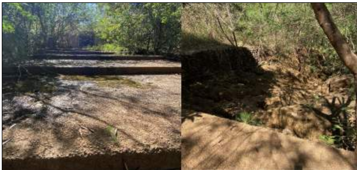
Condição em 2022: significativo adensamento da vegetação e carreamento completo do enrocamento que existia à jusante
