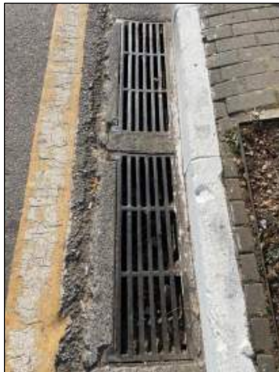
Figura 3-XXV: Sinalização viária (faixa contínua amarela) restringindo fluxo sobre a sarjeta onde as grelhas são instaladas- São Paulo, SP
