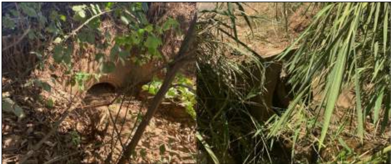
Figura 2-XLVI: Tubulações de passagem com seção reduzida, com comprometimento quase total do funcionamento
