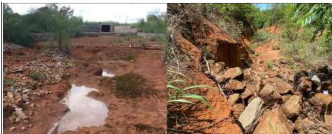
Figura 2-XXXIX: Processos erosivos por entalhamento do terreno, à jusante de estruturas de drenagem (Sussuapara)
