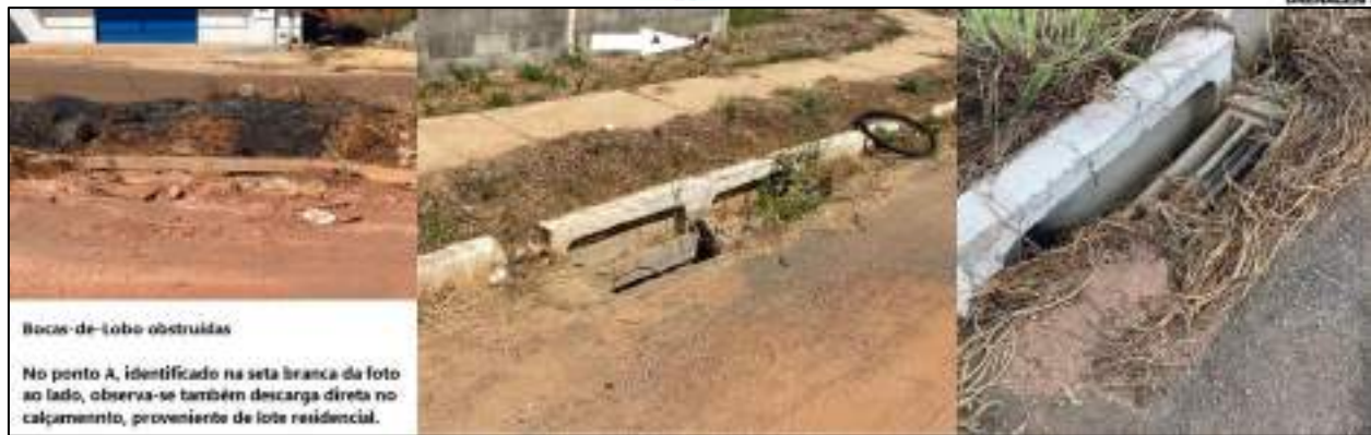
Figura 2-XLV: Exemplos de Bocas-de-Lobo obstruídas
