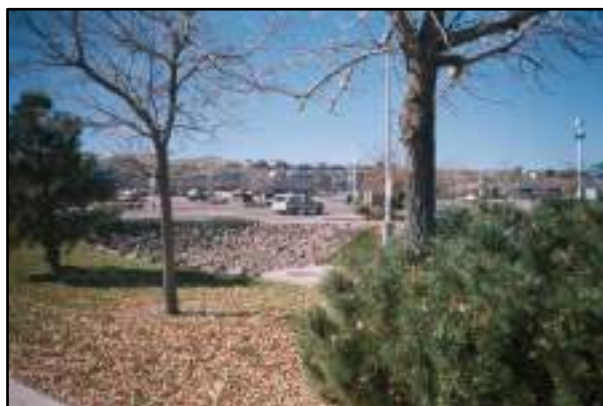
Figura 3-VI: Detenções e Infiltrações em praças e rotatórias
