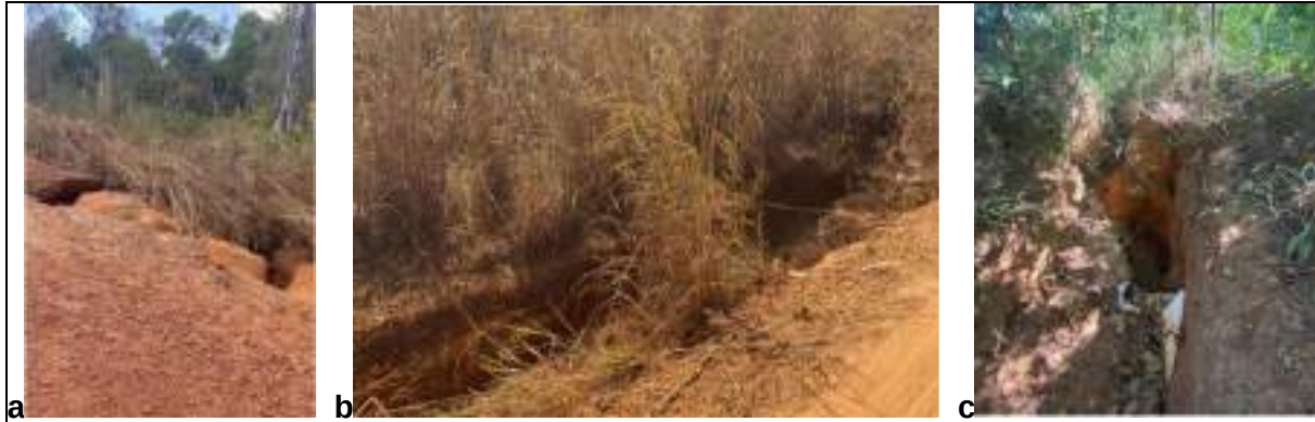
Figura 2-XXXVIII: Processos erosivos por escoamento superficial (a. Machado, b. Taquari, c. Taquaruçu Grande) ocasionados por ausência, ou funcionamento inadequado, de estruturas e dispositivos de drenagem – Atualização 2022
