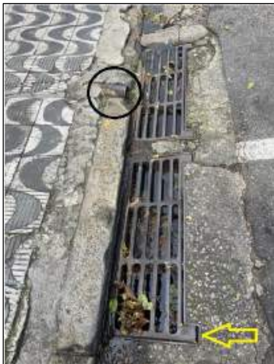
Figura 3-XXIV: Tubulação de descarga na Boca de Lobo e Grelhas de ferro fundido, articuladas- São Paulo, SP
