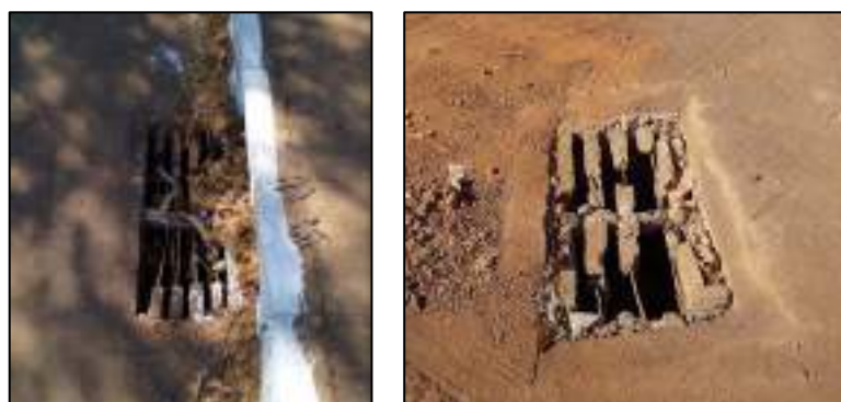
Figura 2-L: Grelhas quebradas devido às cargas do tráfego sobre elas
