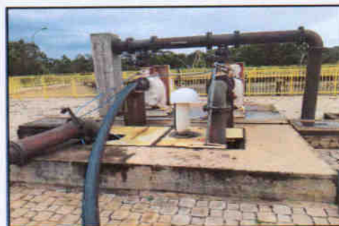
Foto 21 – Tampa de vedação enferrujada, falta placas de advertência e riscos.
