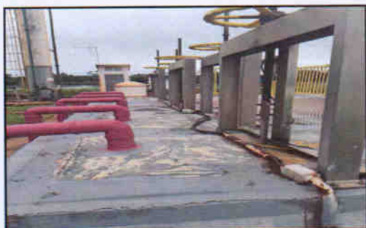
Foto 18- Tubulação da fiação em estado de conservação crítico /enferrujada.
