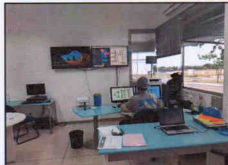
Foto 4 – Sala de controle de automação da ETE.
