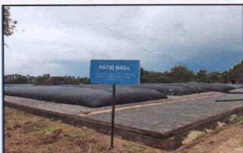
Foto 28 – Disposição do lodo em Patio de Bags com devida sinalização.
