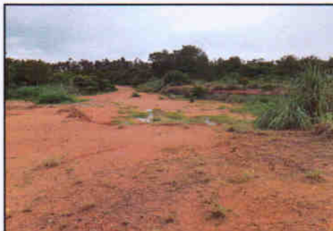
Foto 33 – Área para futuras ampliação do sistema, foi identificado solo em processo erosivo e carreamento do solo sentido área verde.
