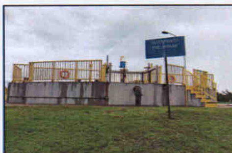
Foto 5 - Vista do sistema de tratamento preliminar.
