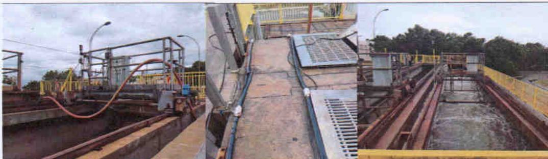
Foto 7- Estrutura sistema com partes enferrujadas, canaletas de proteção de fios quebrados, fio soltos, cordas, sem sinalização de advertência e proteção.
