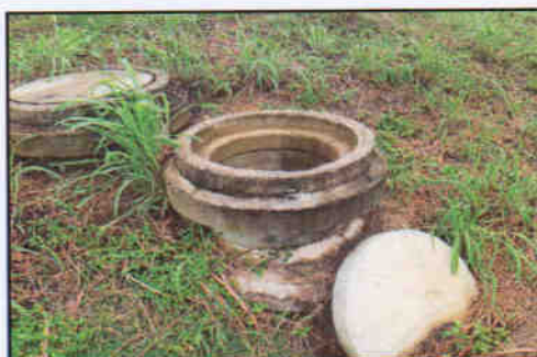
Foto 19 – PV sem tampa e identificação.
