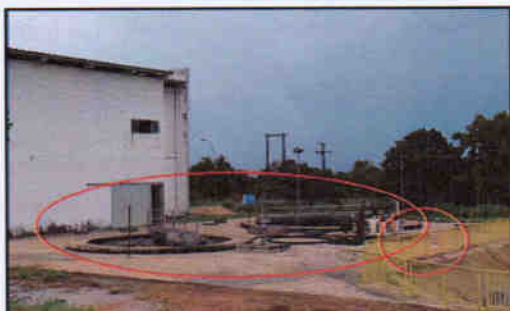
Foto 22 – Vista do flotador sem guarda corpo(a esquerda), falha na grade de proteção do tanque de lodo(a direita).
