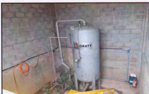
Foto 24 – Falta identificação, placa de advertência do perigo e a placa de sinalização do extintor em cima de um galão de plástico.
