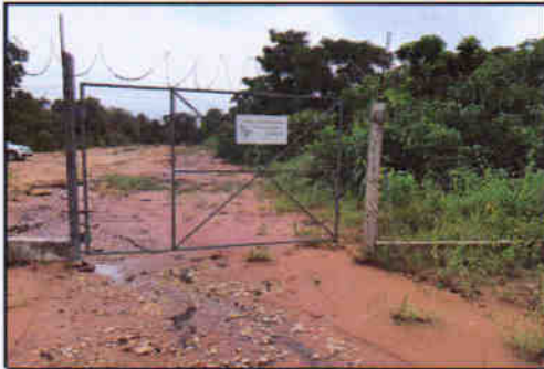
Foto 30 – Portão de acesso a área do emissário, a área é possível identificar processo erosivo e carreamento do solo sentido ao lago.
