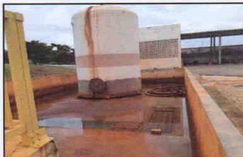
Foto 25 – Mangueira jogada, acúmulo de água, falta identificação e placa de advertência.
