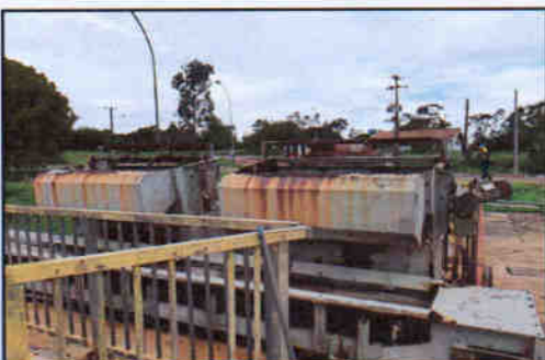
Foto 26 – Vista do sistema de gradeamento mecanizado com presença de ferrugem e falta de manutenção.
