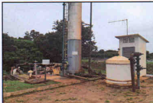
Foto 27 – Falta placa de identificação, e placas de sinalização e advertência de perigo mau estado de conservação.
