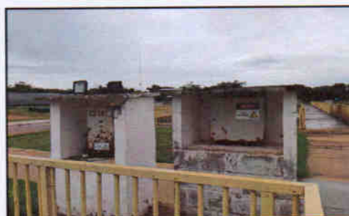
Foto 17 – Pannel de controle de eletricidade em estado de conservação crítico.
