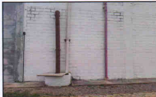
Foto 23 – Tampa de vedação solta, falta placas de indicação da tubulação e riscos.
