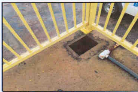
Foto 6 – buraco sem proteção e sinalização no sistema preliminar.
