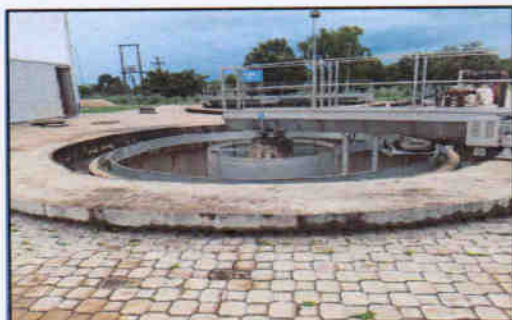
Foto 20 – vista do flutador sem grade de proteção, placa de advertência e indicação dos riscos.
